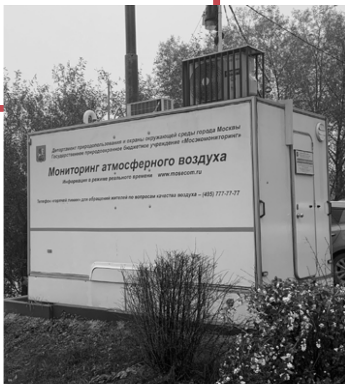
Рисунок 4. АСКЗА на территории района Чертаново Южное по адресу: ул. Дорожная, д. 32
