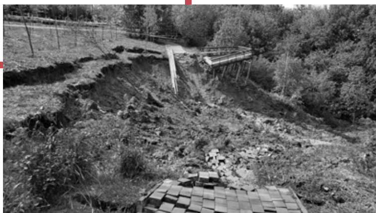
Рисунок 23. Активизация оползневого процесса вблизи жилого дома по адресу: Пятницкое ш., д. 10 (участок Сходня-8)
