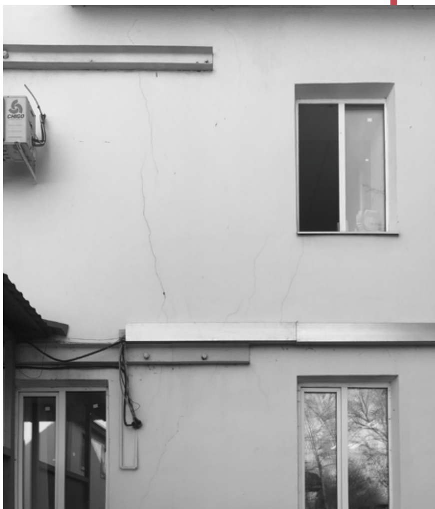
Рисунок 7. Трещины на стене офисного здания по адресу Каширское ш., д.43к3
